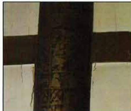
被害③ 漆喰に亀裂
