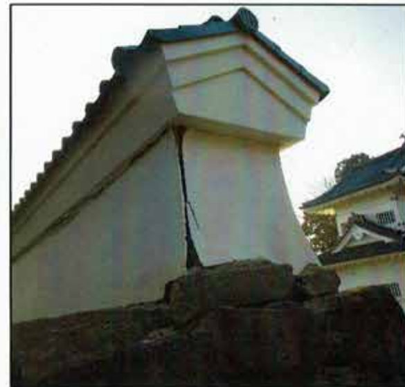
③土塀の亀裂
